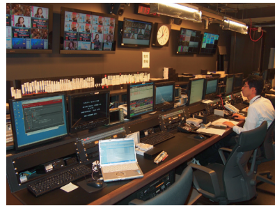
小金井局にある送出センター。ここから関東エリアの番組が送出される
