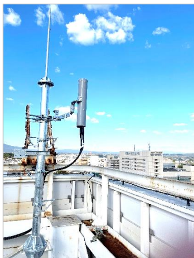
<ローカル5G アンテナ設備>
