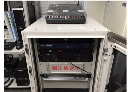
FM用緊急割り込み装置(富士吉田市防災無線室)
