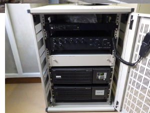
屋外拡声子局 制御BOX内部
