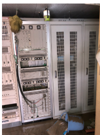
当社真備サブヘッドエンド被災状況
