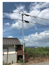
幹線にUHFアンテナを接続した応急処置
